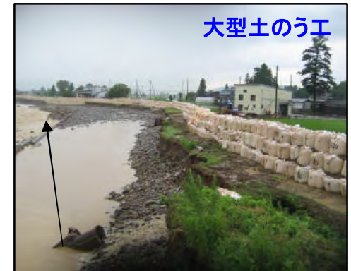
三条市江口地先 堤防決壊箇所
